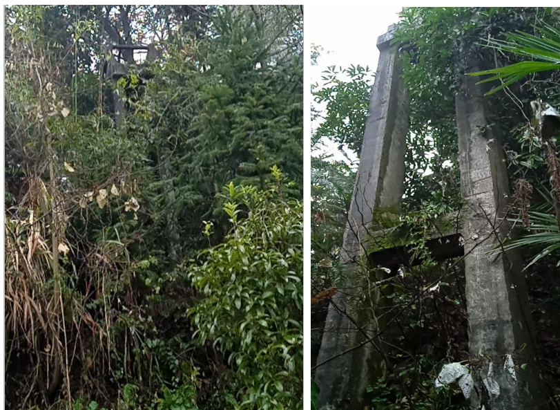
已断头、垮塌的西干渠渡槽
